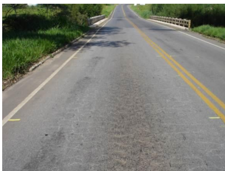
Figura 10 - Trinca classe 2 TR2 (área de superfície trincada – m 2 ).
