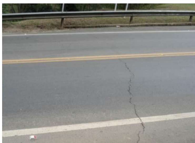
Figura 21 - Trinca transversal TT (unidade - und).
