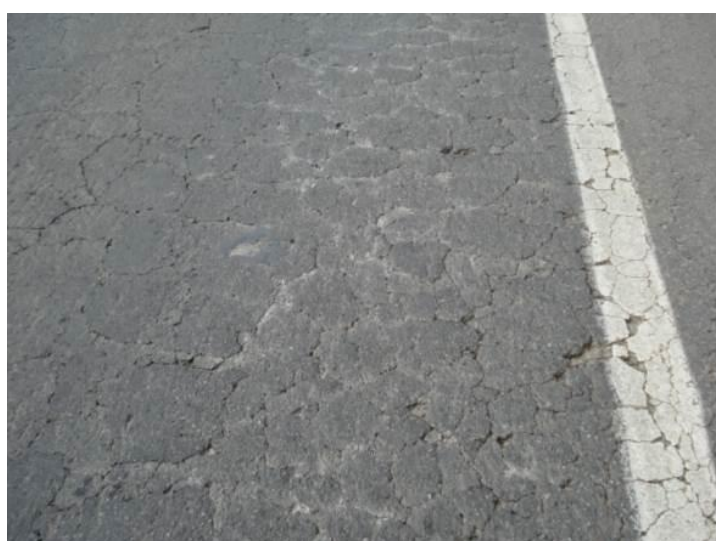
Figura 9 - Trinca classe 3 TR3 (área de superfície trincada – m 2 ).
