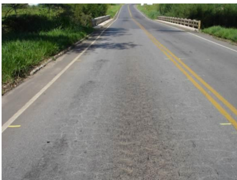
Figura 3 - Trinca classe 2 FC-2 (área de superfície trincada, m 2 ).
