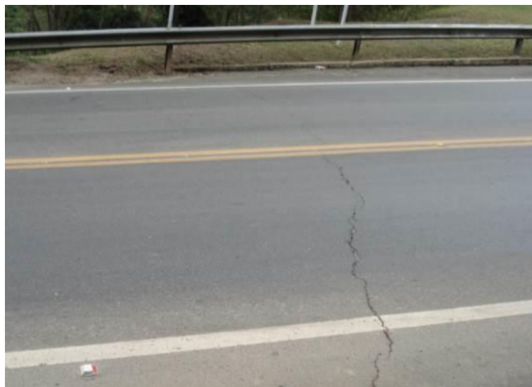
Figura 2 - Trinca transversal (unidade, und).
