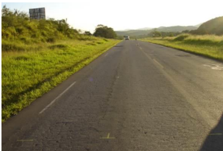
Figura 6 - Afundamento da trilha de roda (extensão, m).
