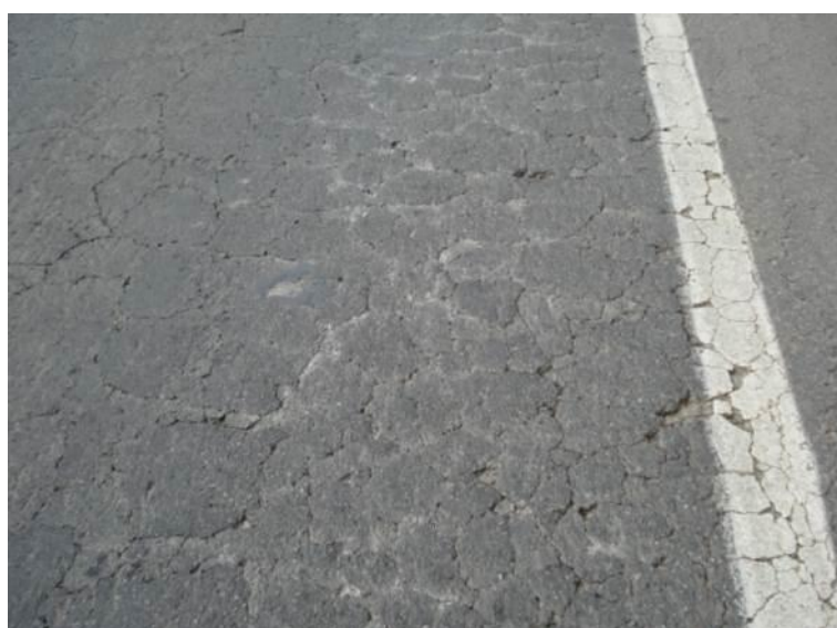
Figura 4 - Trinca classe 3 FC-3 (área de superfície trincada, m 2 ).
