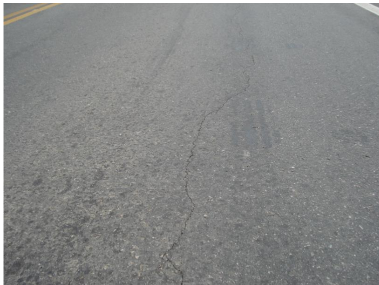
Figura 1 - Trinca longitudinal (extensão, m).
