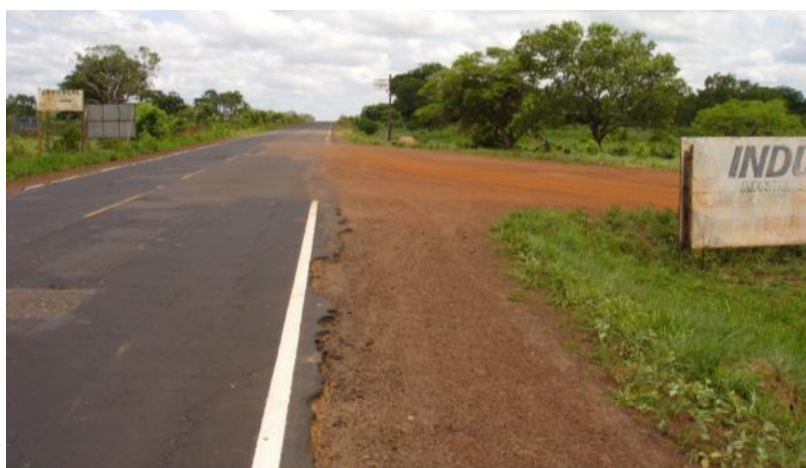
Figura 15 - Quebra de bordo QB (área de superfície com quebra de bordo, m^2 ). Esse defeito começou a ser medido pelo DNIT na campanha de LVC de 2006, devido à solicitação deste no modelo HDM-4.
