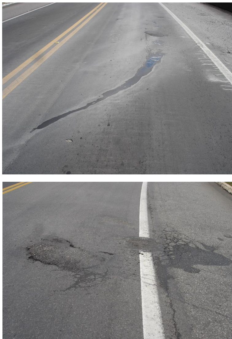
Figura 14 – Bombeamento de água no pavimento (número de pontos de bombeamento, und).
