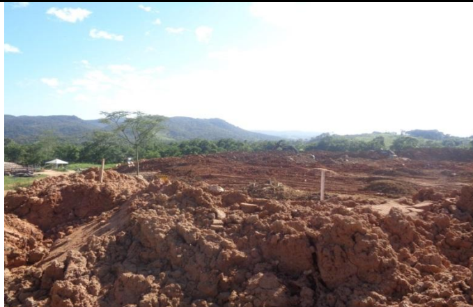
Figura 04 – Local para Bota Fora, km 213+750
