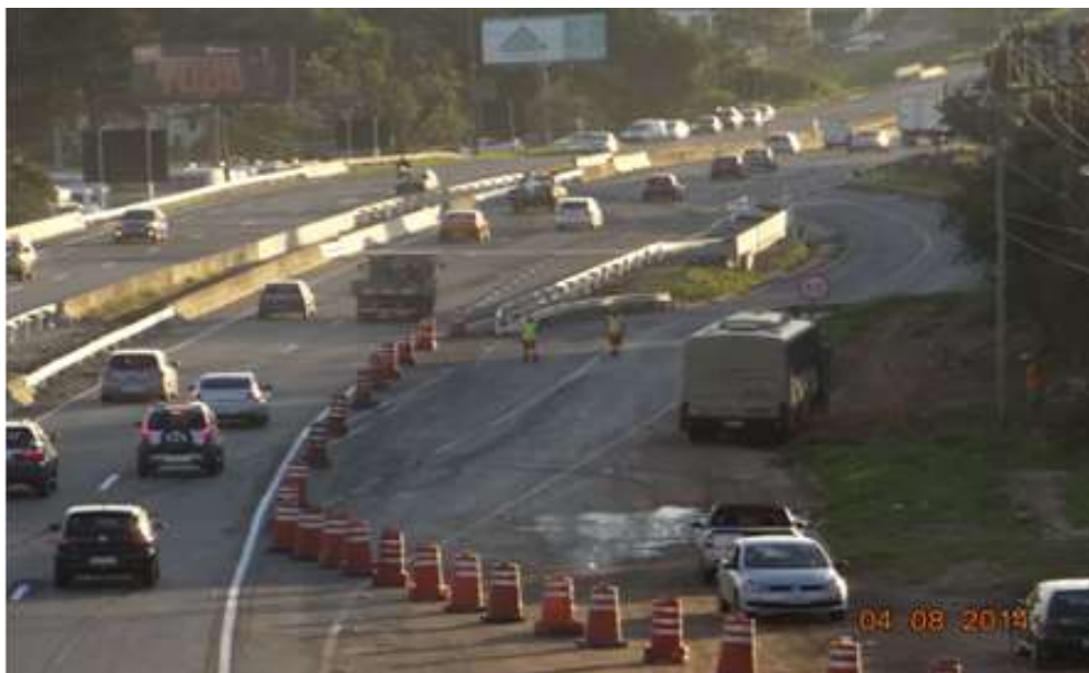
Figura 23 – OBRA PARALISADA – Vista geral Dispositivo Km 17+530.
