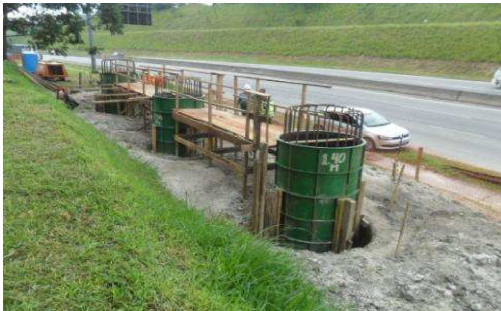
Figura 20 – OBRA PARALISADA - O.A.E – Trevos em Desnível, com Alças, em Pista simples - km 277+600 Embu das Artes.
