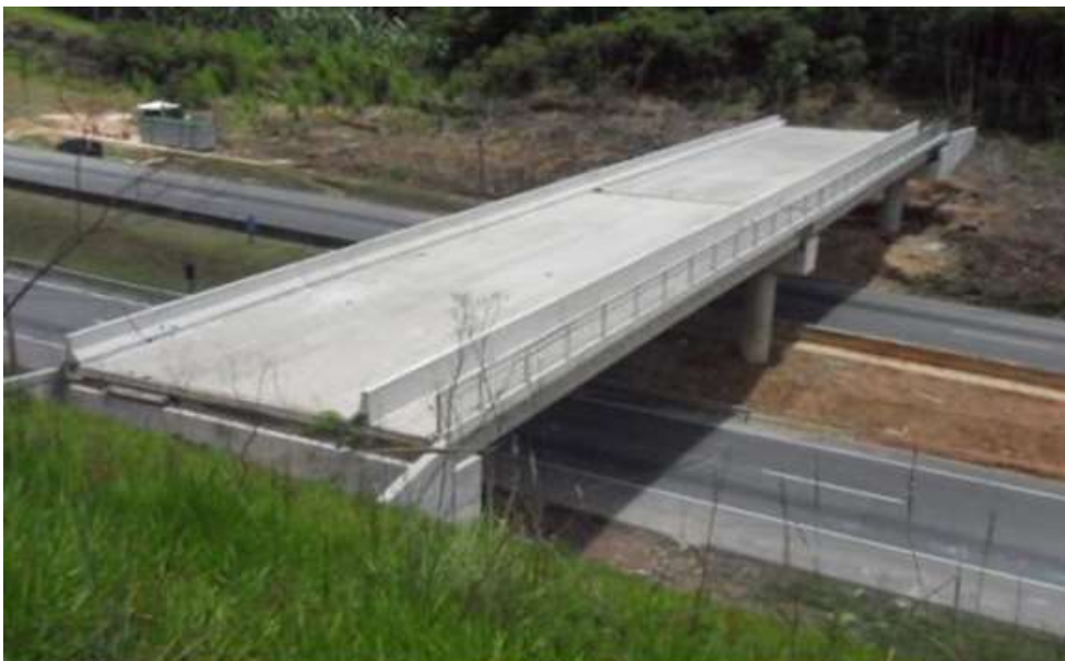
Figura 22 – OBRA PARALISADA - O.A.E – Trevo em Desnível, com Alças, em Pista Dupla - km 332+000 Juquitiba.
