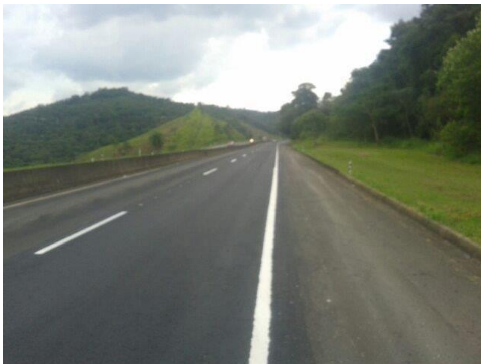
Figura 02 – Pavimento Flexível – km 803+600 sentido JF.
