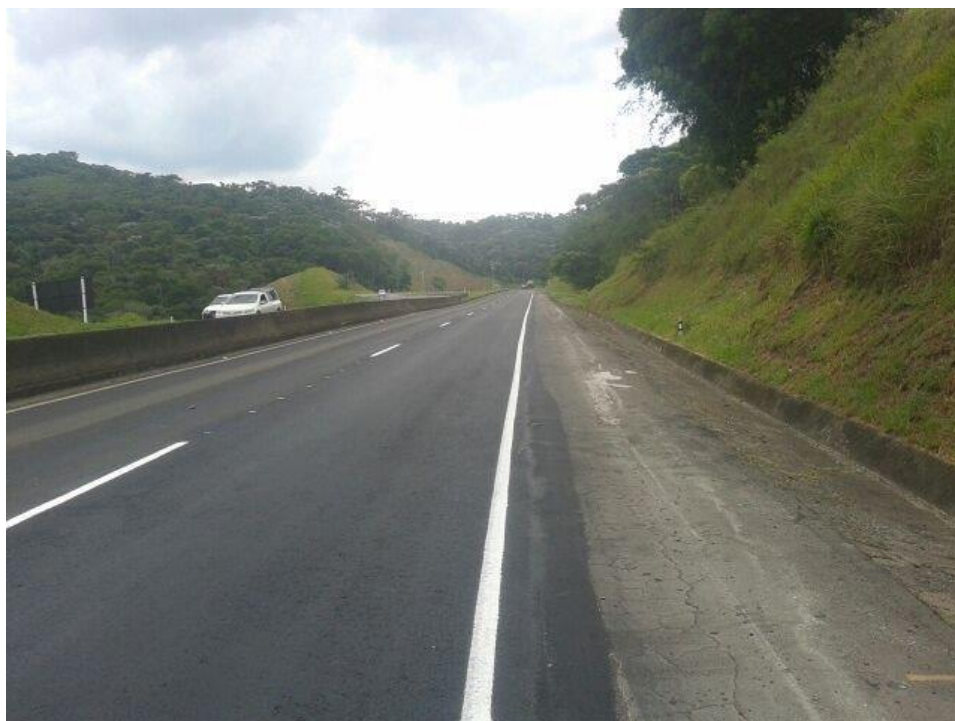
Figura 01 — Pavimento flexível – km 803+600 sentido JF.
